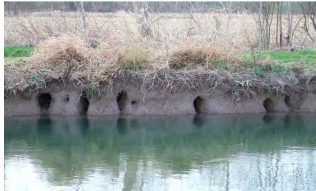
Photographie 1. Dégâts d'une berge causés par le ragondin
